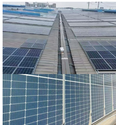
山東宏創工廠屋頂光伏發電
